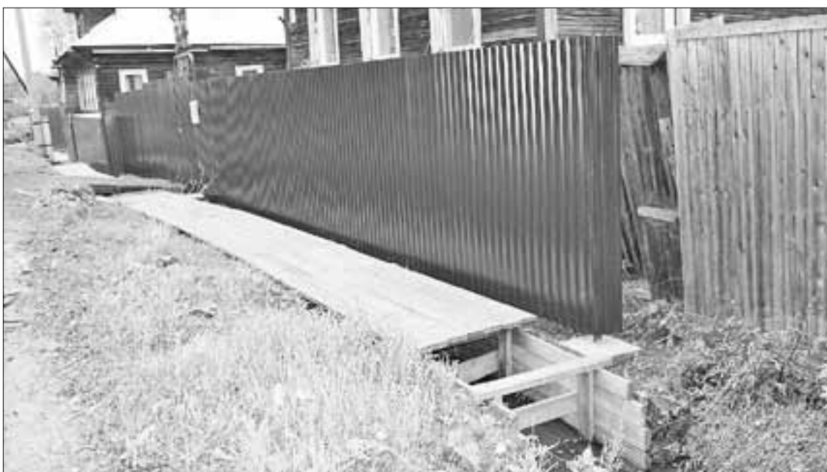
■ Ремонт дренажно-ливневой канализации на улице Суханова – это уже третий проект ТОСа «Кемский». ФОТО: КСЕНИЯ НАЙДИЧ
